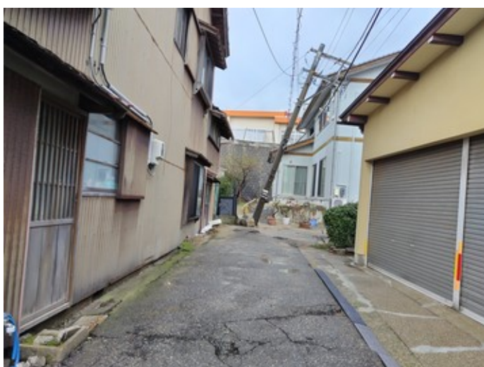
33.電柱の傾き,道路の亀裂
