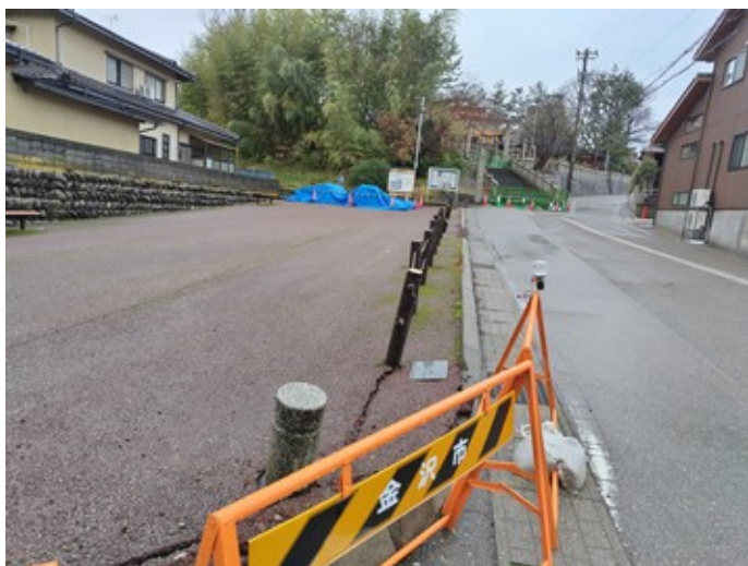
21.液状化によるポールの傾き
