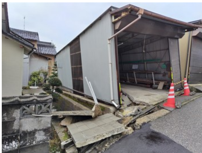
31.大きな段差が生じている
