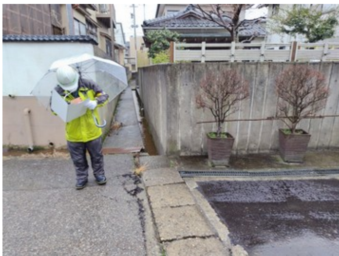
13.水路付近で液状化の痕跡あり
