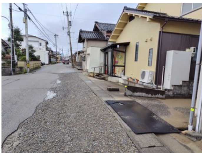
39. 家屋の沈下および傾斜, 電柱の傾斜
