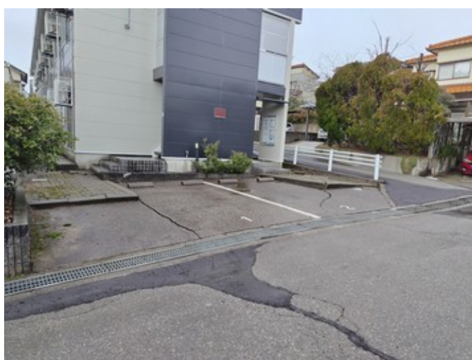
45.道路両側とも大きな亀裂と段差
