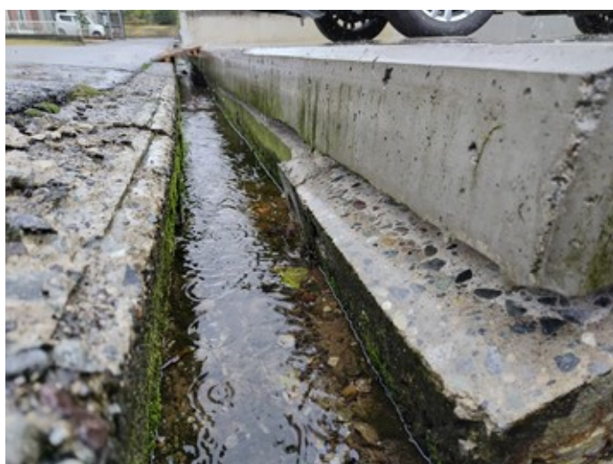
16.コンクリート床板のズレ
