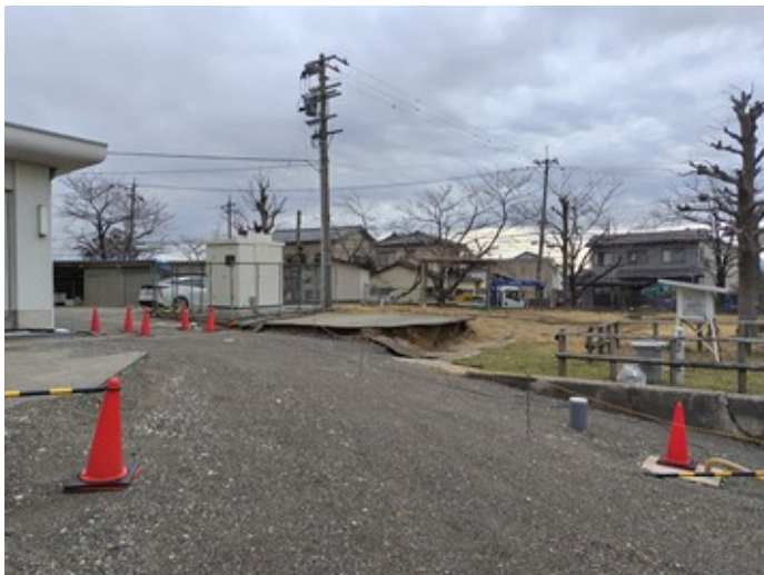
1. 栗崎小学校南東端(敷地盛土の沈下)
