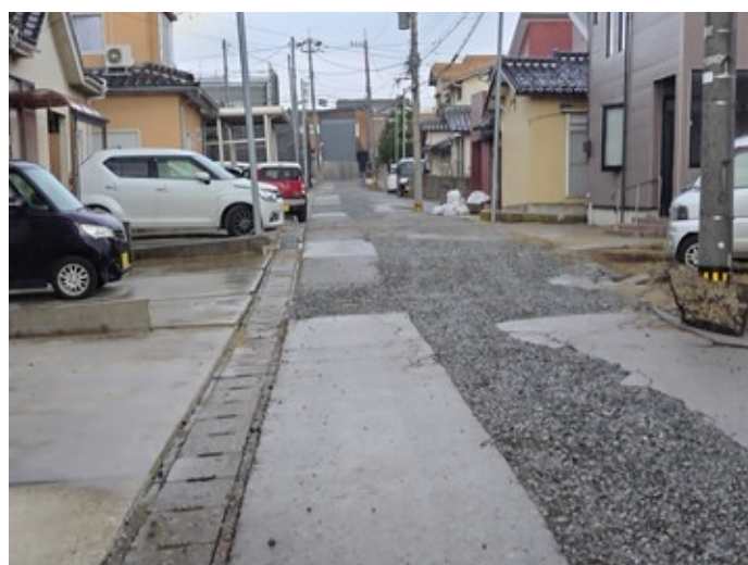
11.液状化による沈下が認められる
