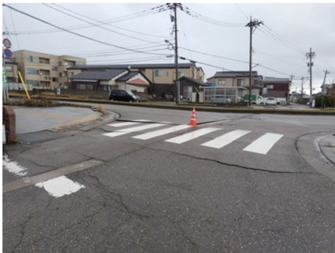
47.内灘町,46 からの変状は続いている
