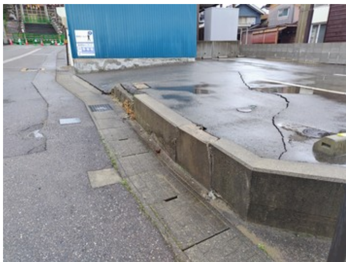
22.駐車場の亀裂
