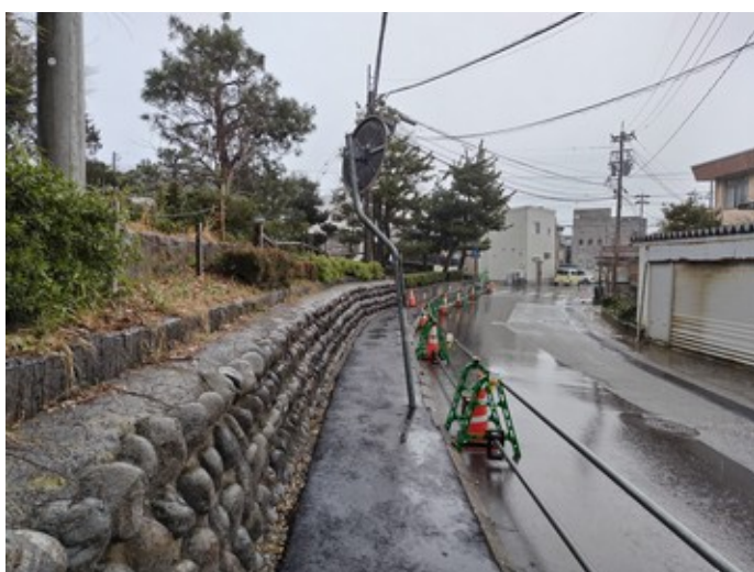
14.小学校下の道路の変状
