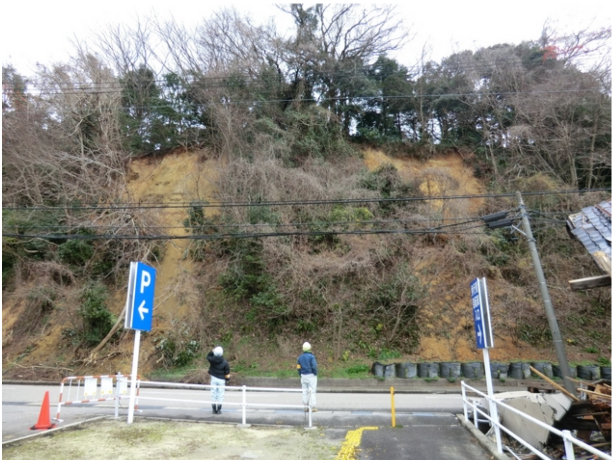
岩石崩落横の表層崩壊
