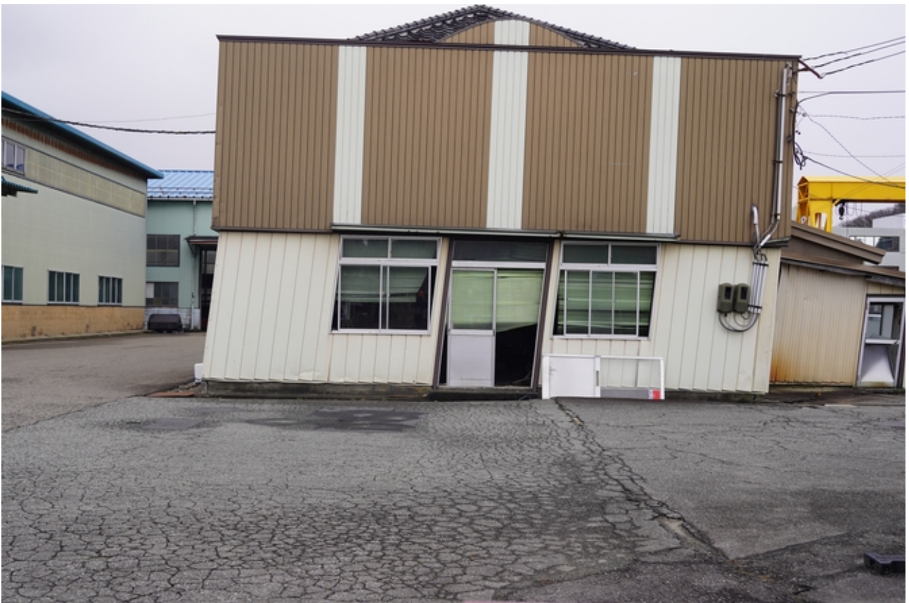
同様に液状化による建物被害
