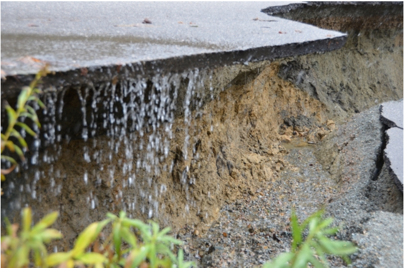
山側側溝から溢れた水が崩落地点まで流れ込んでいた
