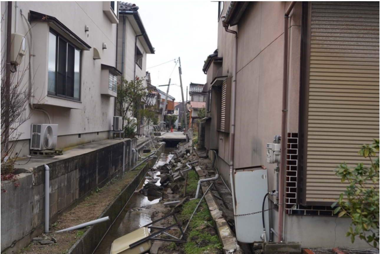
七尾港水源地付近の水路周辺での液状化
