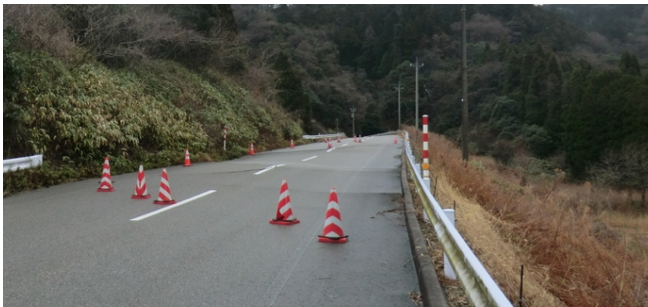
腹付け盛土の変状
