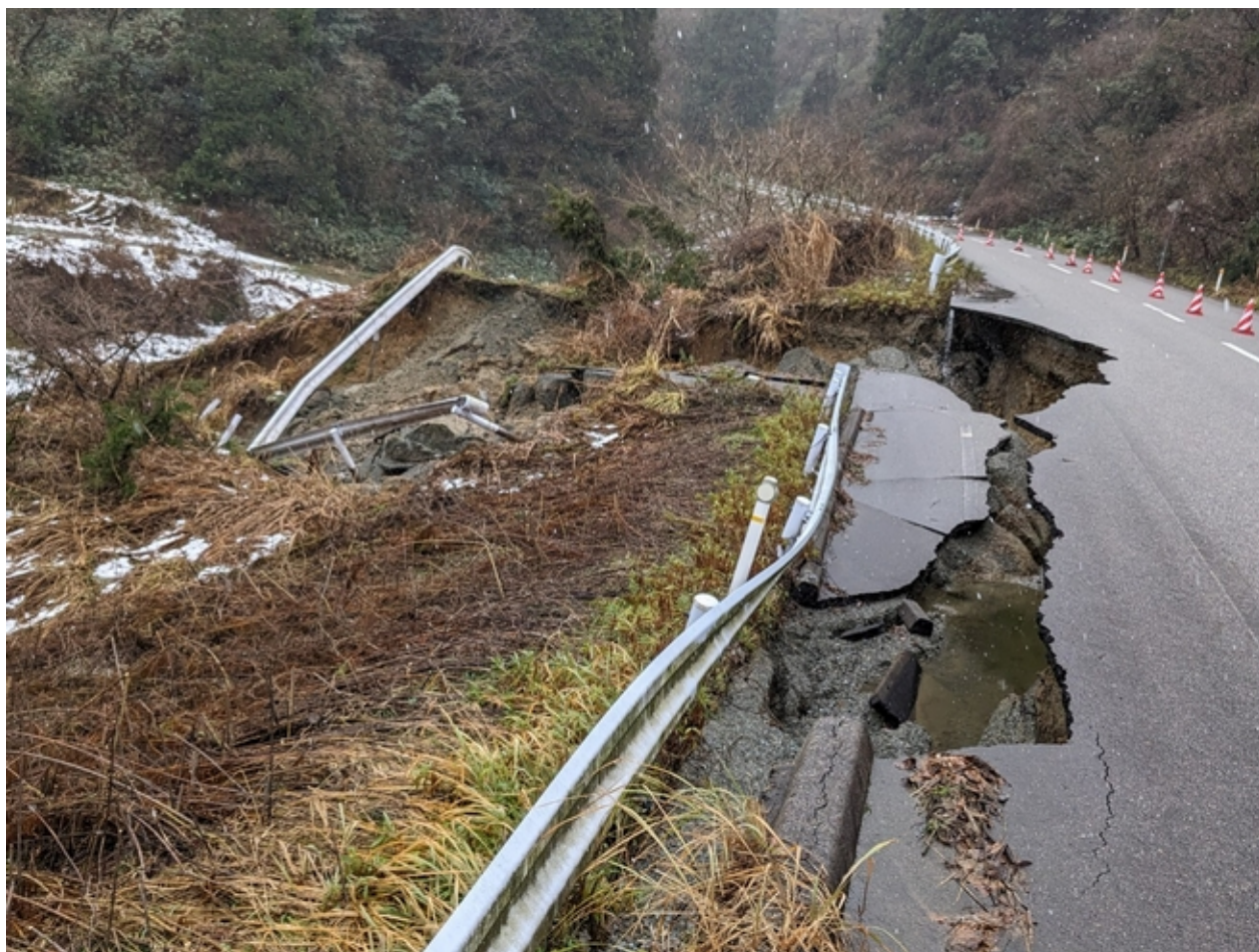
盛土の崩落(1月9日調査時点では崩落なし. その後の降雨・降雪にて顕在化)
