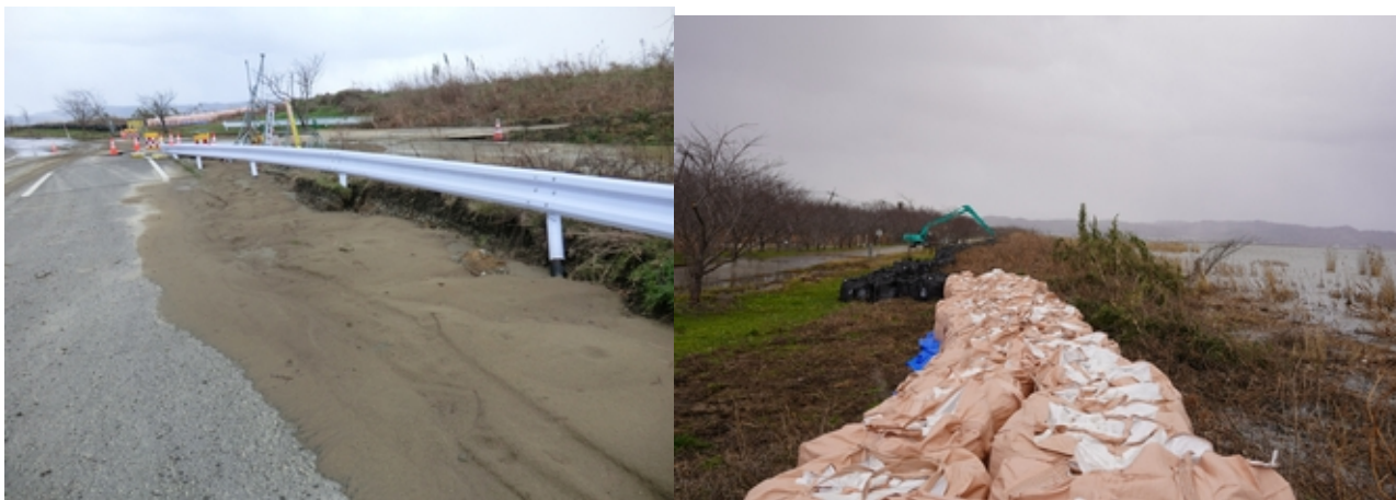
液状化による堤防の揺すり込み沈下(水面とほとんどさがない)
