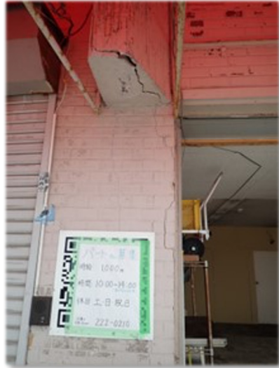
柱のひび割れ
